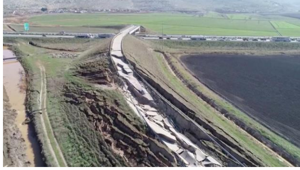
Şekil 16: Deprem esnasında meydana gelen büyük çaplı bir kütle hareketi sonucunda bozulan köy yolu görülmektedir.
