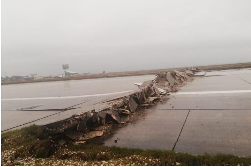
Şekil 26: Görselde görüldüğü üzere Antakya Havalimanı depremde kırılarak garip bir görüntü almıştır. Deprem sonrasında 6 gün hizmete kapanan hava alanı, yer seçiminde yapılan hatanın net olarak anlaşıldığı bir yerdir.
