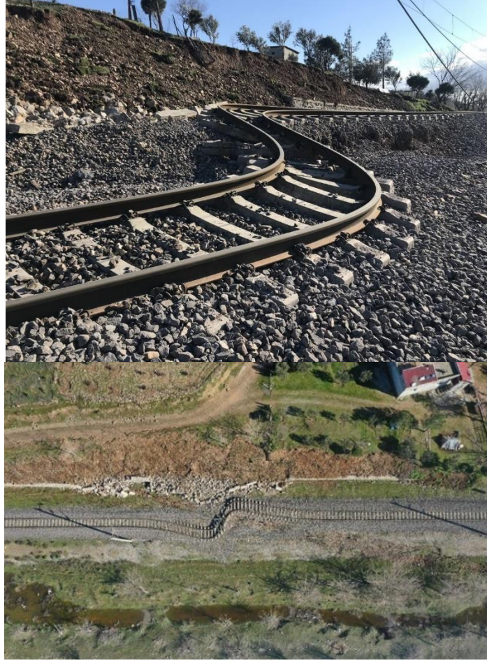
Şekil 14: Fay hatları ile kesişen demiryollarında bozulma ve ötelenmeler dikkat çekicidir.
